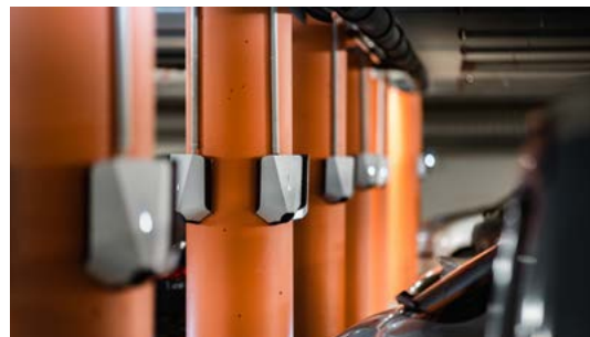
Bei mehreren Ladestationen ist ein Lastmanagement zentral
