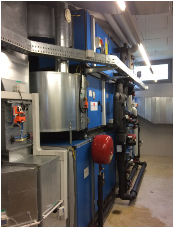
Lüftungsgeräte in Zentrale
