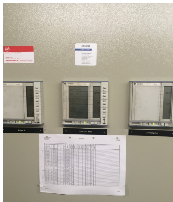
SGK Heizung – Raumautomation in Unterstation
