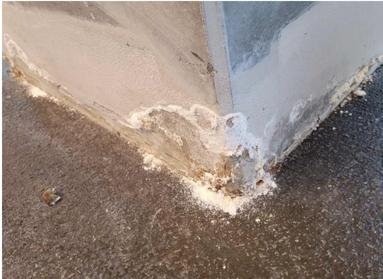
Abb. 4: Ausblühungen am Fuss der Beton-Stützenfüsse in der Eishalle
