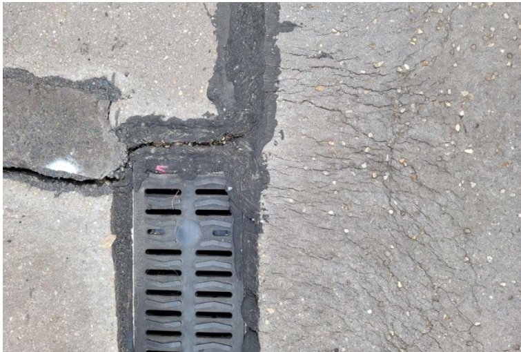
Abb. 6: Risse im Gussasphalt
