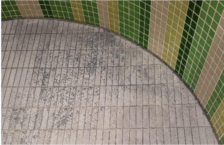
Abb. 1: Beschädigte Oberflächen im Bereich der Dusche Wellness
