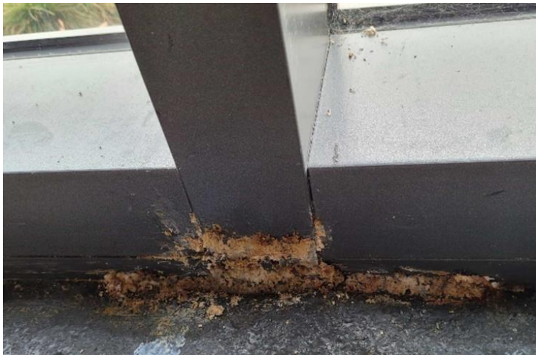
Abb. 5: Materialablagerungen am Fuss der Metallfassade der Eishalle
