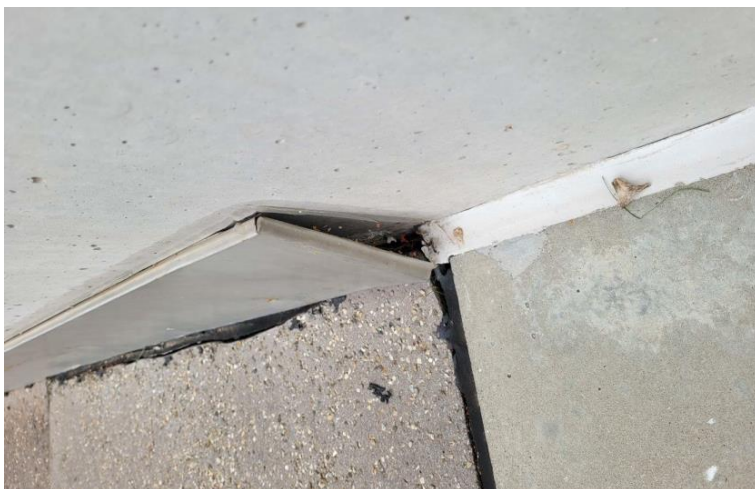
Abb. 7: Defekte, verbogene Abdeckbleche an aufgehenden Gebäudeteilen
