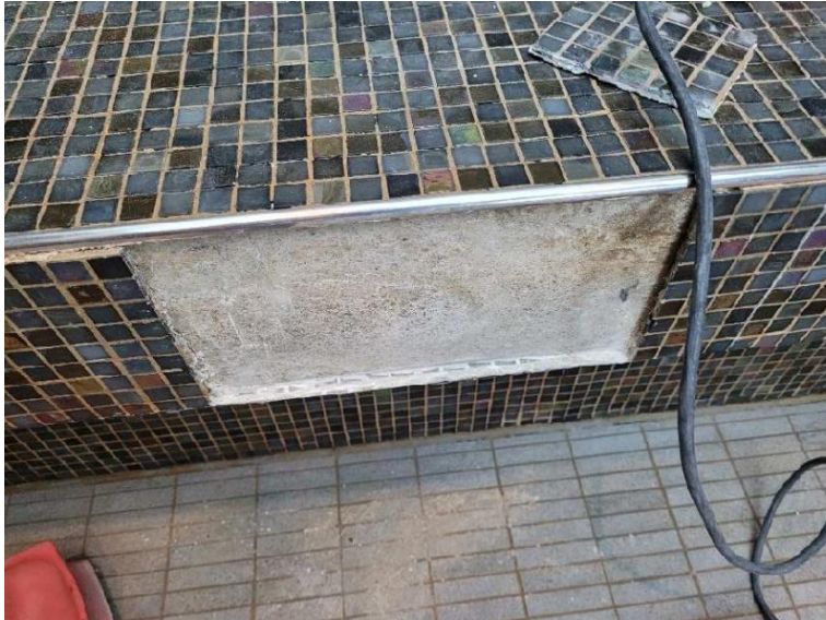
Abb. 9: Ablösung von Glaskeramikplatten im Dampfbad
