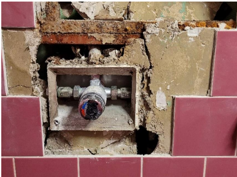
Abb. 3: Verrostete Unterkonstruktion bei den Duschen im Bereich Fussball
